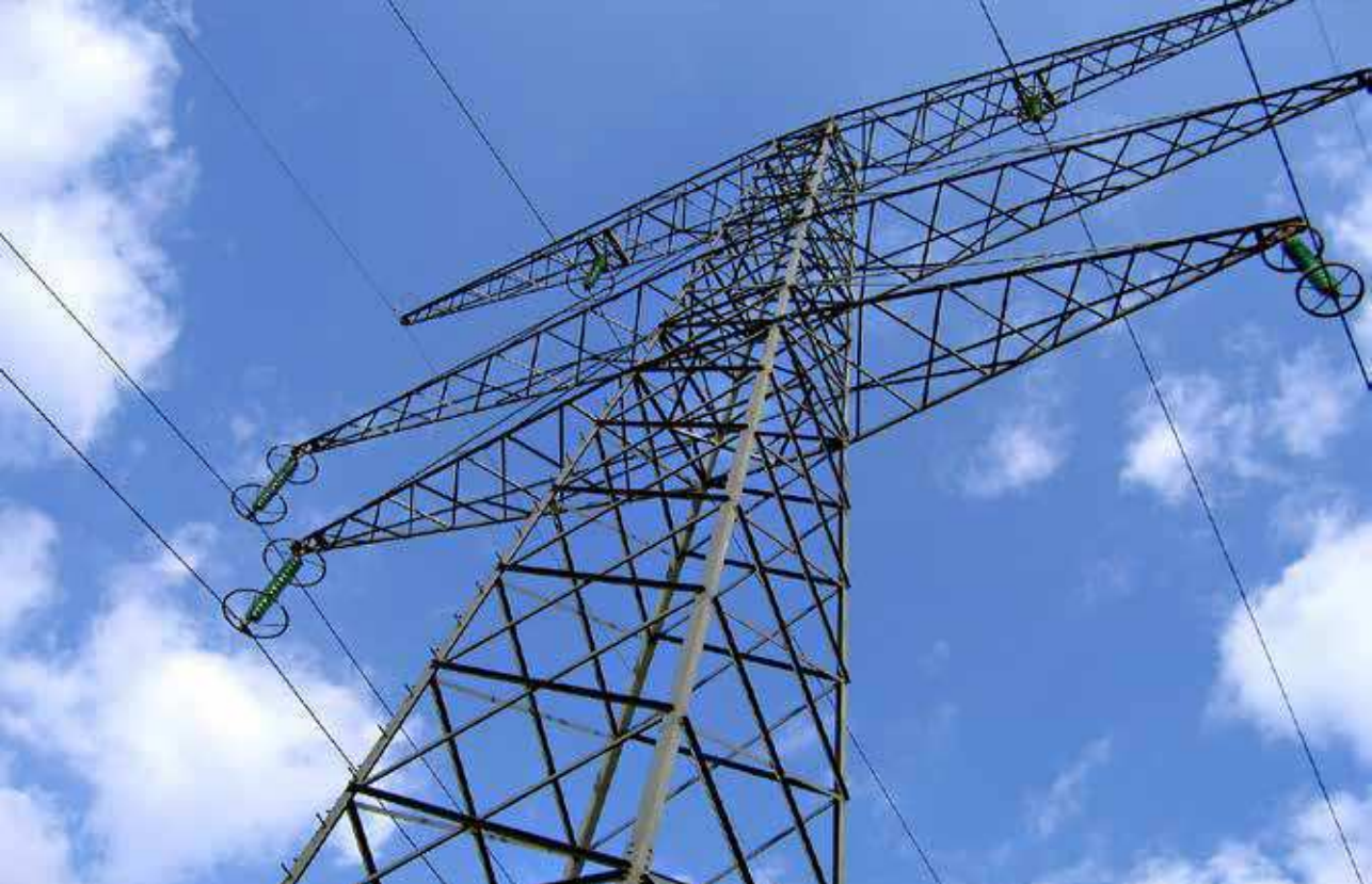
Líneas de Transmisión Eléctrica
