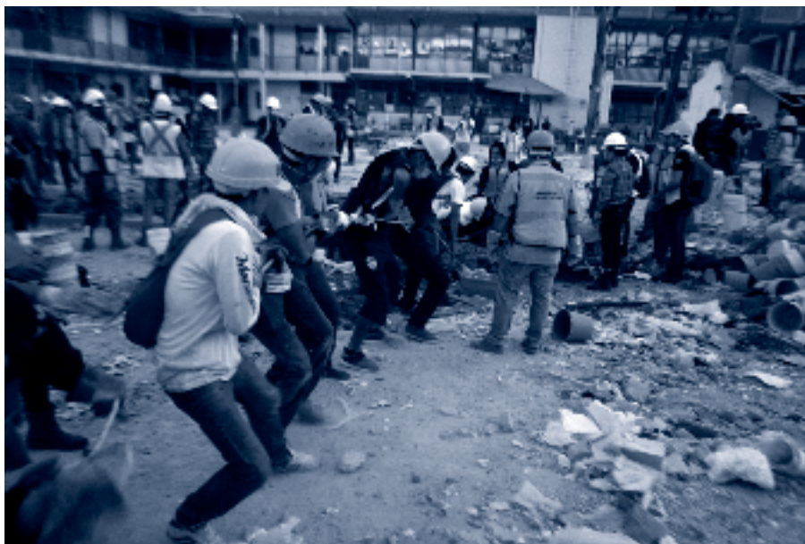
Labores voluntarias en edificio colapsado en Ciudad de México Foto: ProtoplasmaKid, via Wikimedia
