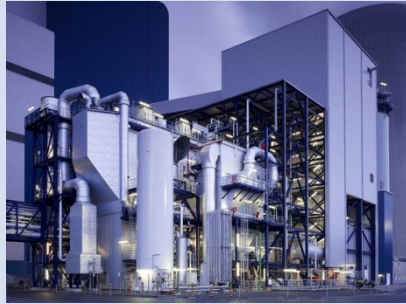
WTA®-Prototyp seit Ende 2008 ⇒ Wirkungsgradsteigerung
