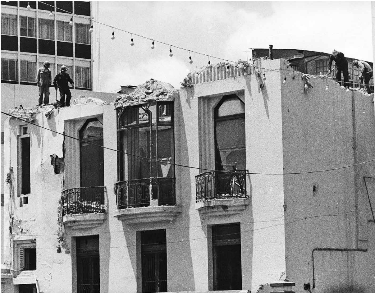
Destrucción de la COB.
