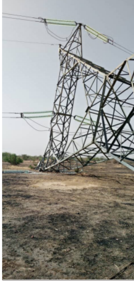
أبراج نقل الطاقة الكهربائية المستهدفة
